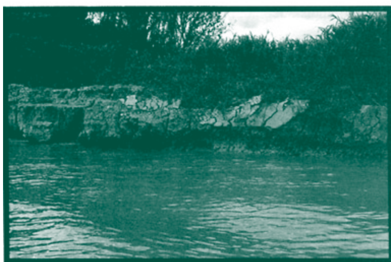
FOTOGRAFIA 1.5: DANOS ÀS MARGENS PRODUZIDOS POR COMBOIOS
