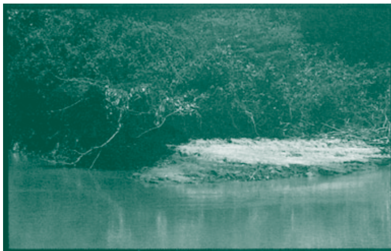
FOTOGRAFIA 6.21: DANOS ÀS MARGENS PRODUZIDOS POR EMBATE DOS COMBOIOS
