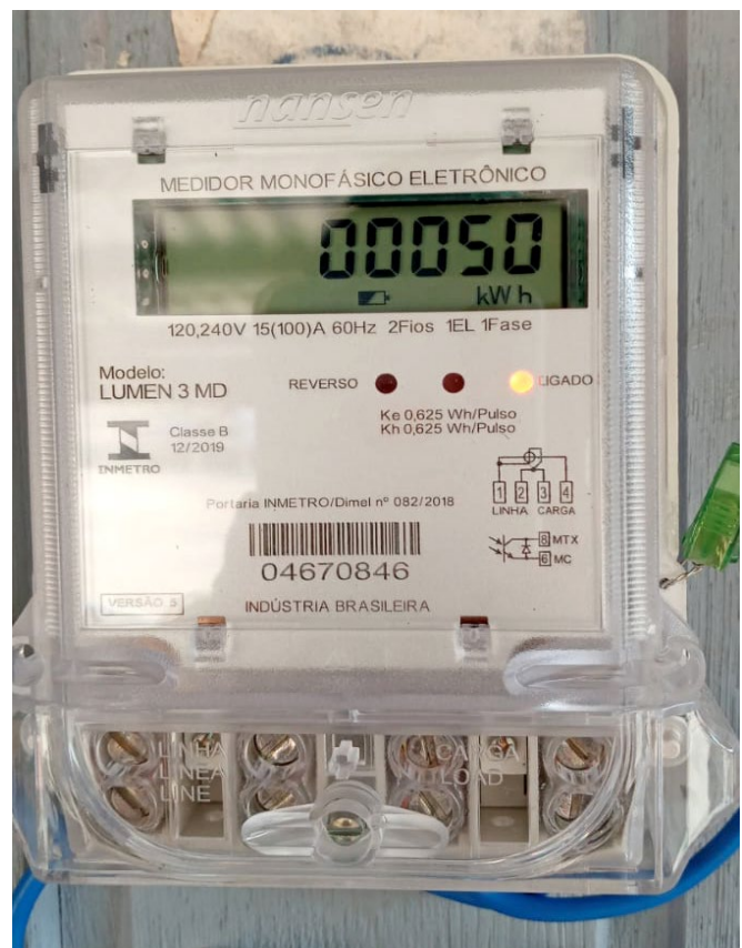
Figura 4 – Foto de medidor de energia.
