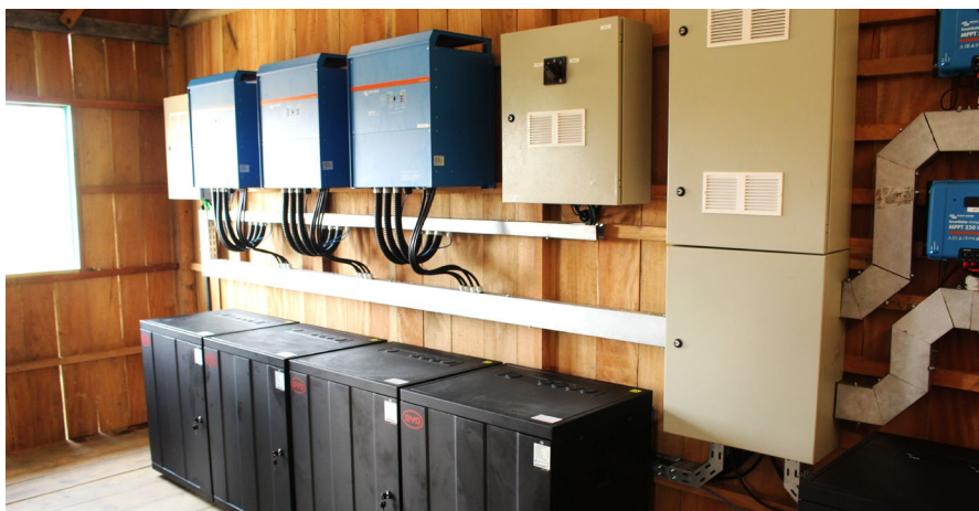
Figura 2 – Interior da casa de força da usina com banco de baterias, inversores e controladores. Fonte: WWF-Brasil, 2021.
