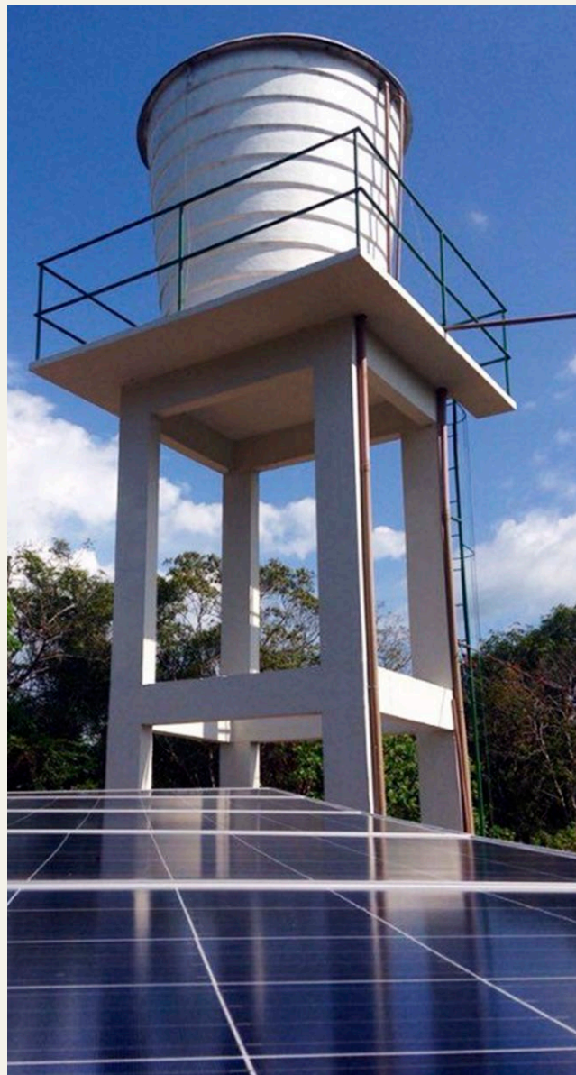
Foto 7 – Bombeamento solar. Local: RESEX Tapajós. Fonte: PSA, 2016
