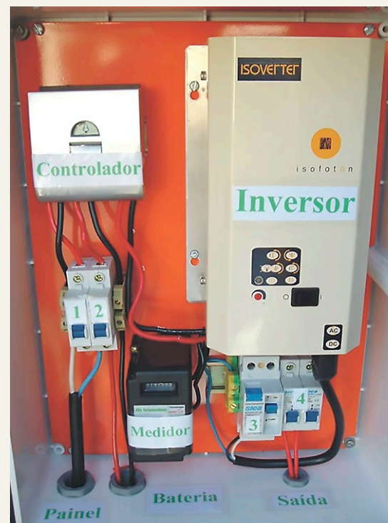
Foto 17 – Detalhe de sistema solar residencial
