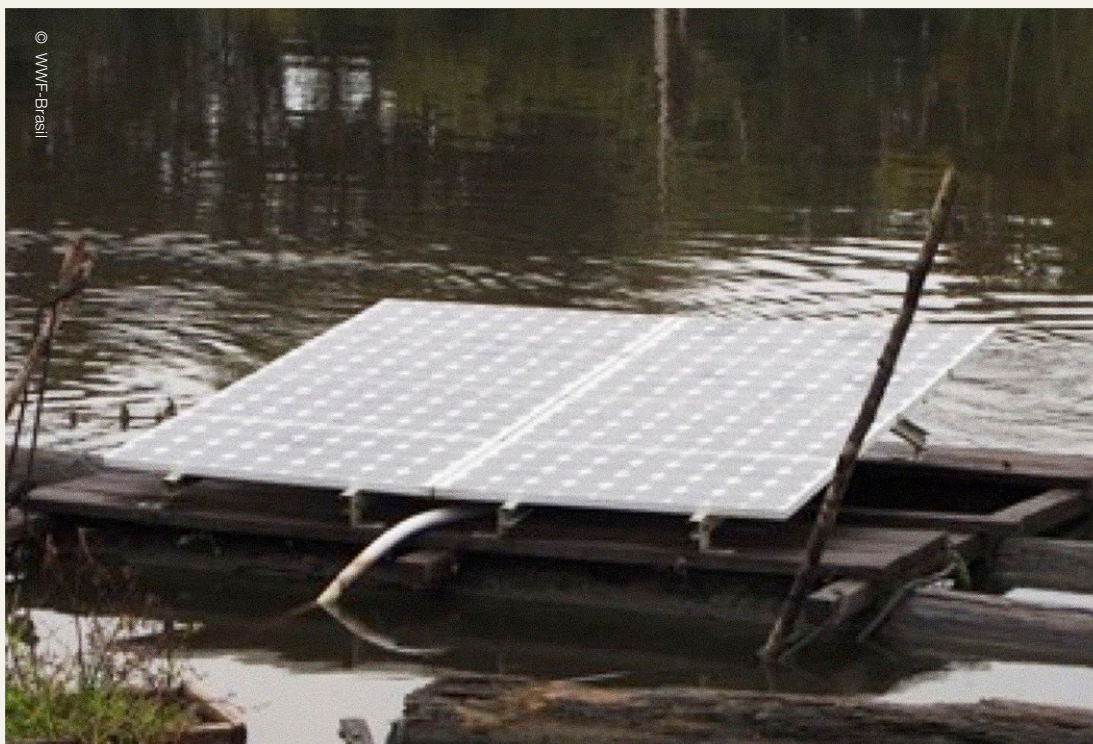
Foto 3 – Sistema de bombeamento de superfície. Local: Reserva Mamirauá. Fonte: Usinazul, 2015.
