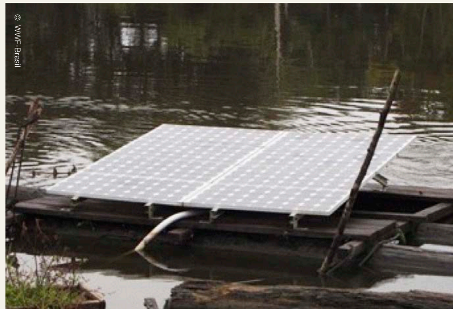
Foto 6 – Sistema de bombeamento de superfície na Reserva de Desenvolvimento Sustentável Mamirauá
